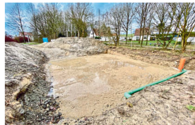
Hinter der Bonitas-Kurzzeitpflege liegt ein Regenauffangbecken. Es bleibt bestehen, wird jedoch mit einer Gartenfläche überbaut.
